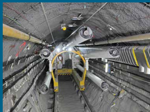
Aufbau des Demonstrationsexperimentes FE im Felslabor Mont Terri: Oben: Bentonitblöcke werden als Sockel für die Testbehälter verwendet. Unten: Die Verfüllmaschine des Experiments im FE-Stollen
