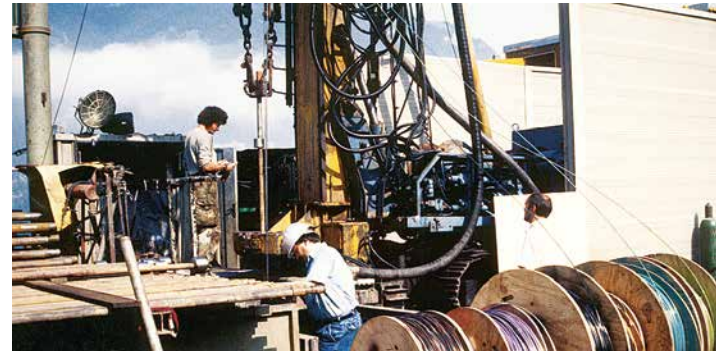
Einbau eines Packersystems in ein Bohrloch für die Langzeitbeobachtung: Die farbigen Leitungen führen in die isolierten Bohrlochabschnitte. Foto: Nagra
